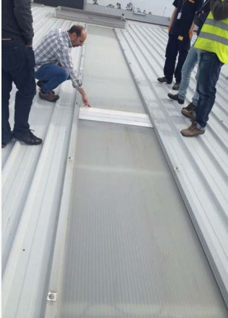
1 – Edifício industrial – Juntas entre placas de policarbonato
