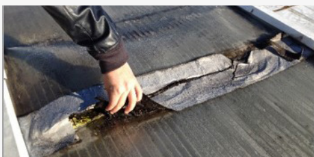
Patologias tipo em juntas de estruturas em policarbonato
